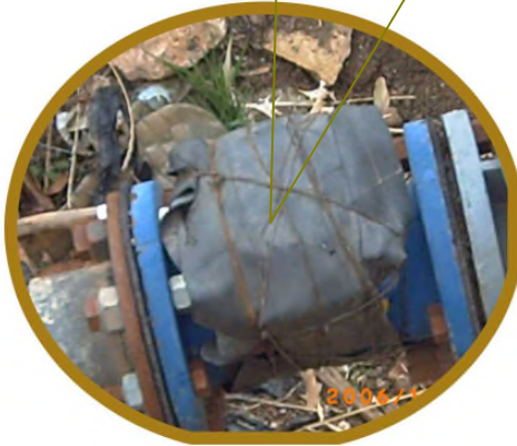
Compteur à l'air libre couvert destiné à la base de vie CONDOTE
