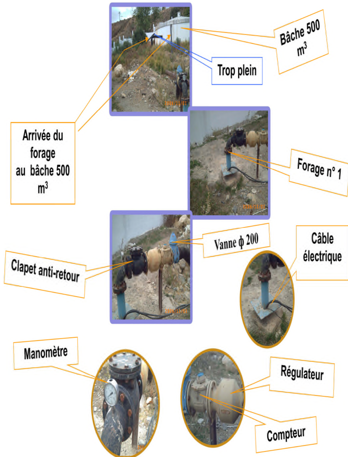
Figure N° II.02 : Equipements de forage 1
