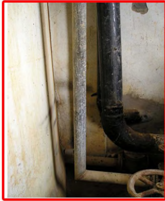
Trop pleine vers le remplissage du R500
