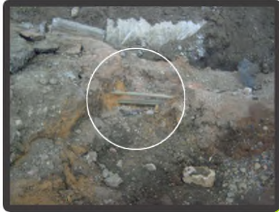
CANALISATION DIVERS 2 POUR AEP ET 1 POUR GAZ
