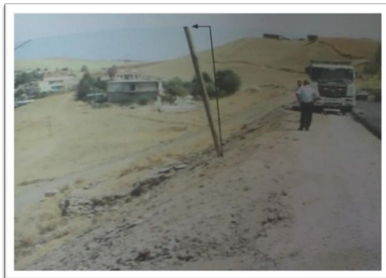
Figure. III.9PK 4+100 : Instabilité au niveau du remblai de la route
