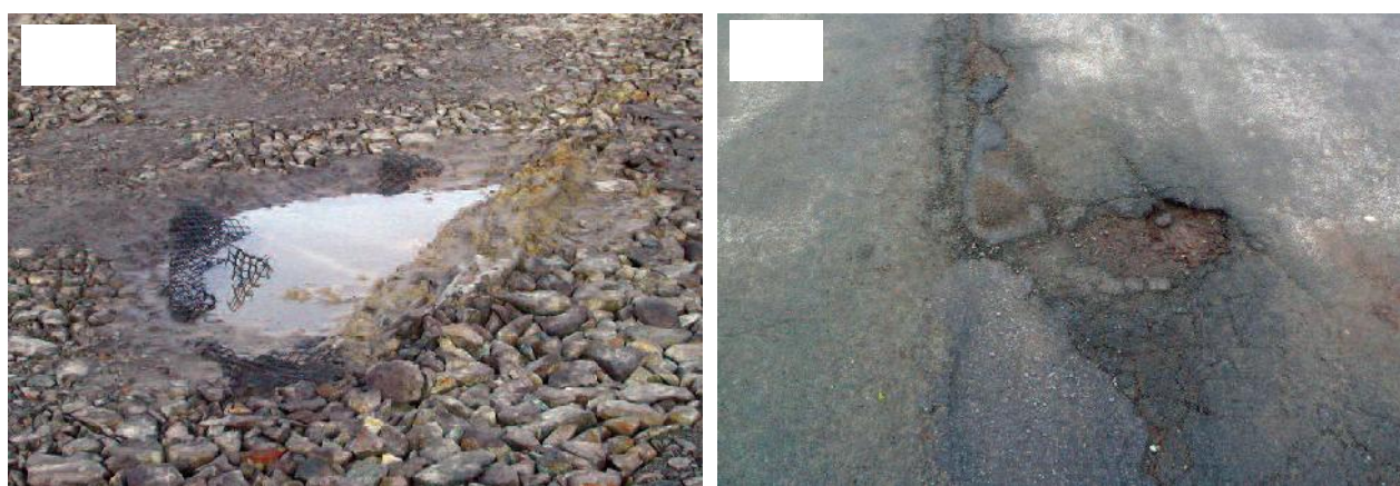
Figure II.6. (a).Remontée des particules fines ;(b) dégâts provoqués par l'eau et le gel
