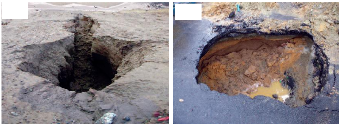
Figure II.10. (a) Glissement de terrain ; (b) Erosion interne
