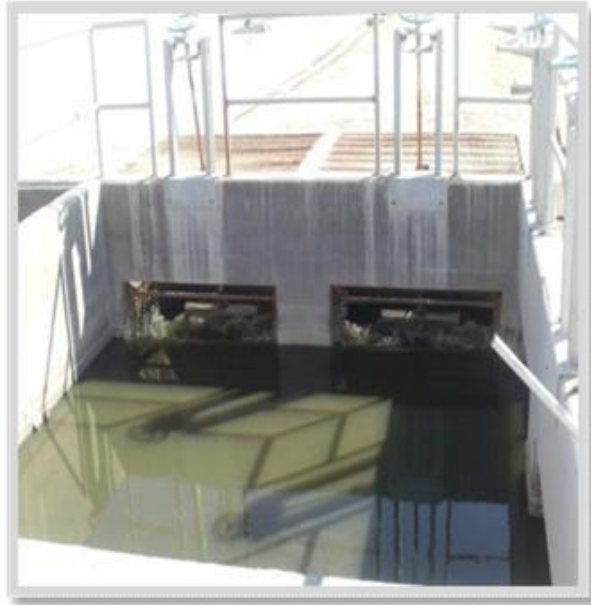
Dessableur-désuilleur et répartiteur
