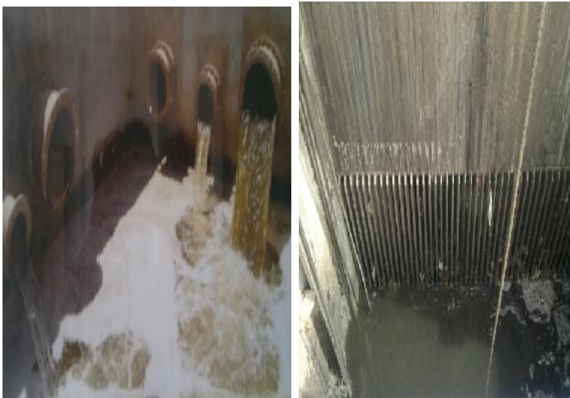
Bassin de dégazage et dégrilleur.
