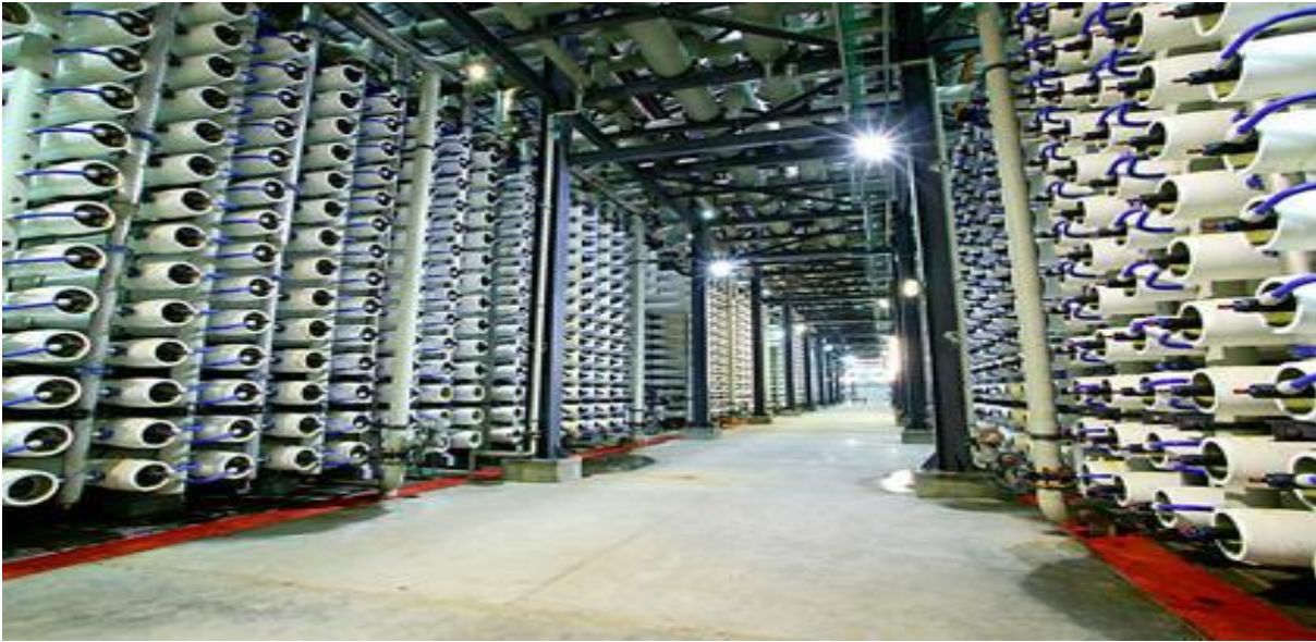
Fig. I.3 : Technique de l'osmose inverse à l'usine d'Ashkelon en Israël
