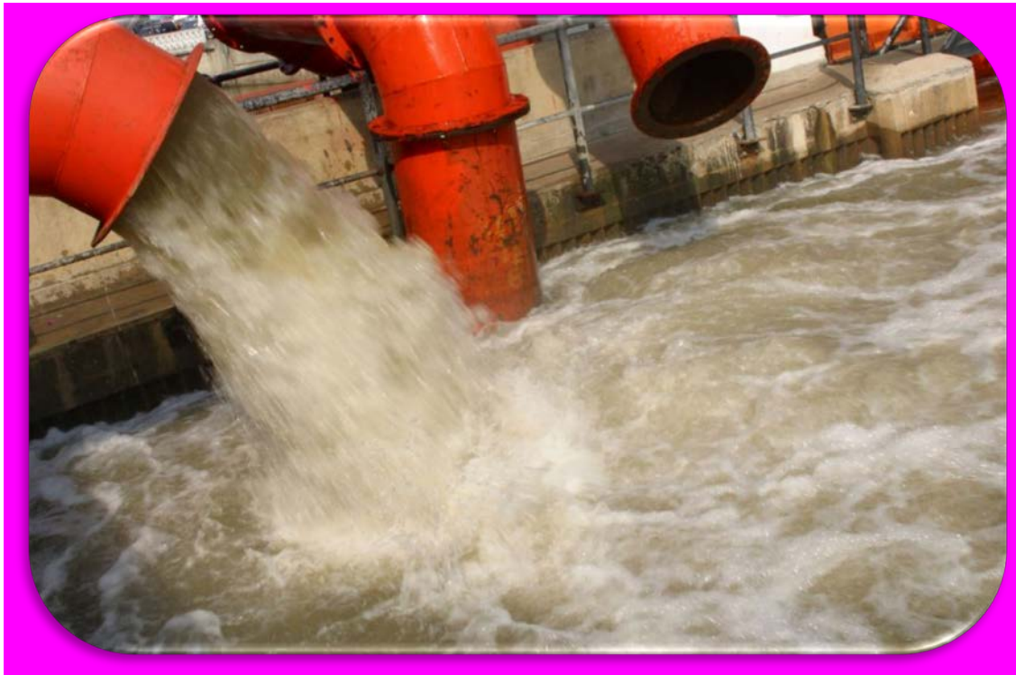
Figure 05: Eaux usées domestiques [10]
