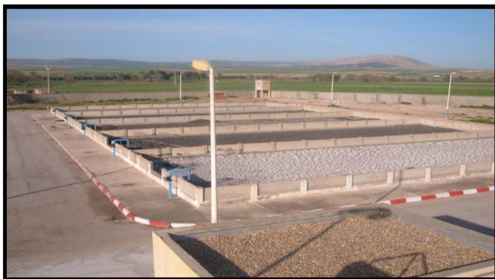
Figure n° 15 : lits de séchage de boues (STEP Oeud Athmania).
