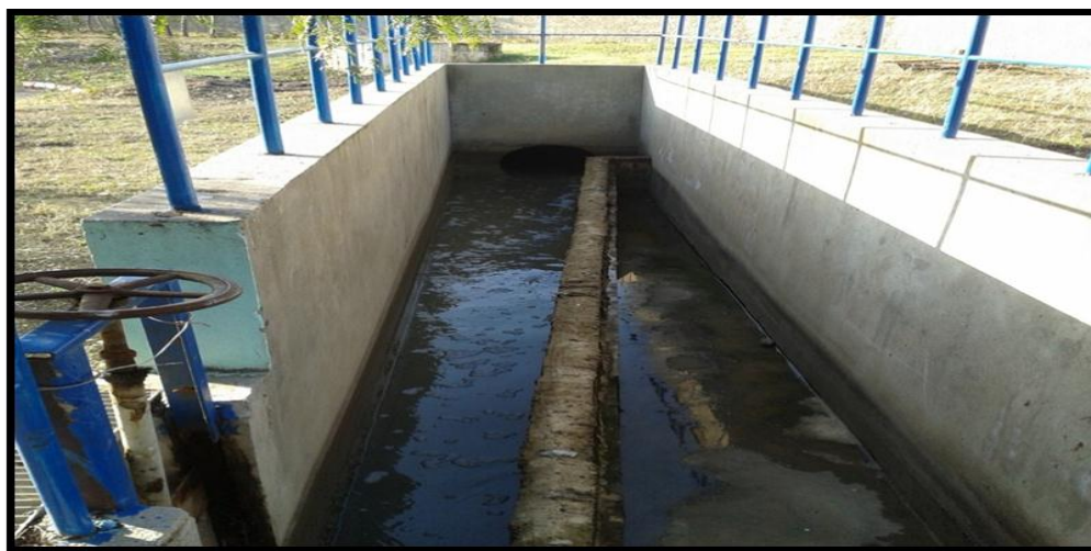
Figure n°09 : Déversoir d'orage (STEP Oued Athmania).
