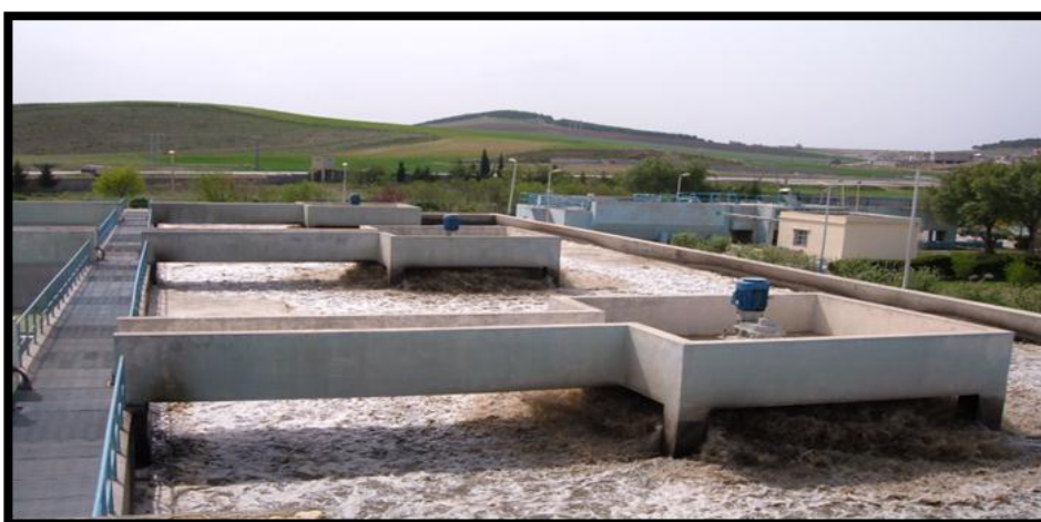
Figure n°12 : Bassins d'aérations (STEP Oeud Athmania).
