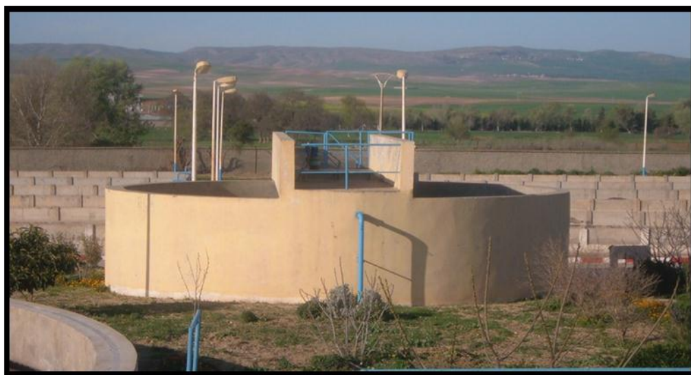
Figure n° 14 : Epaississeur (STEP Oeud Athmania).
