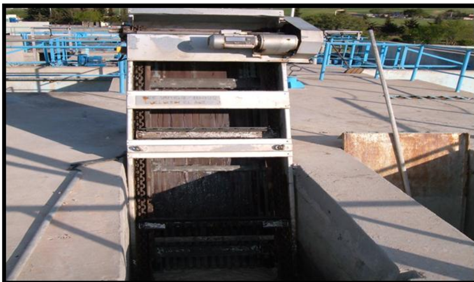
Figure n°10 : Dégrilleur automatique (STEP Oeud Athmania).
